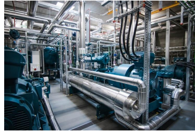
SVAF havvandsvarmepumpe i Sydhavnen – ejet af HOFOR, CTR og VEKS i fællesskab
